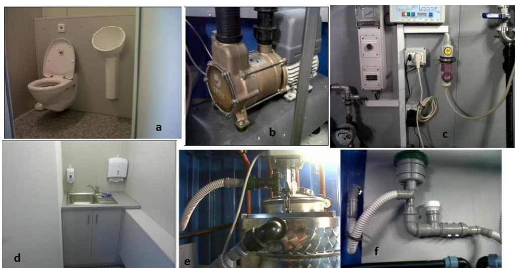
Slika 5: Jets 95 WC in Enswico-Key pisuar in kontejner 1 (a), Jets vacuumator 10 NT AC in kontejner 2 (b), Električni vir energije za delovanje pilotnega sistema (c), sistem za zbiranje sive vode pilotnega obrata za ločevanje črne vode (d), zračno filtrirni sistem z rezervoarjem črne vode (e, f) (foto: Žitnik M., 2015)
