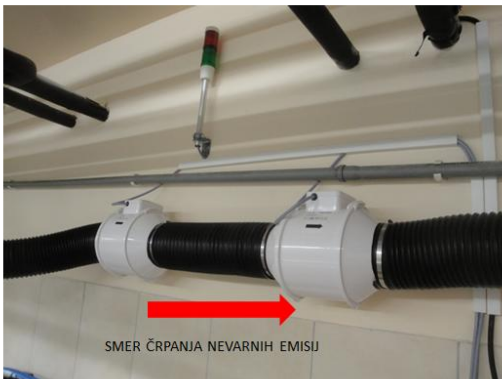
Slika 2: Ventilatorja za izsesavanje nevarnih emisij z alarmom (foto: Prus, 2012)
