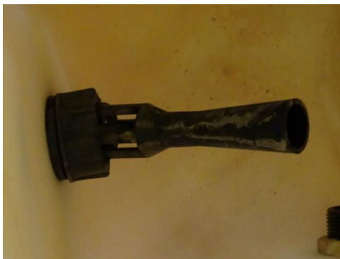
Slika 3: Mešalna (Venturijeva) šoba na dnu rezervoarja Figure 3: Venturi nozzle on the bottom of the tank
