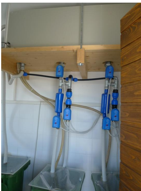
Slika 5: 400 L zadrževalnik črne vode in elektromotorni ventili, ki so posnemali izplakovanje stranišč (foto: Tjaša Cenčič)
