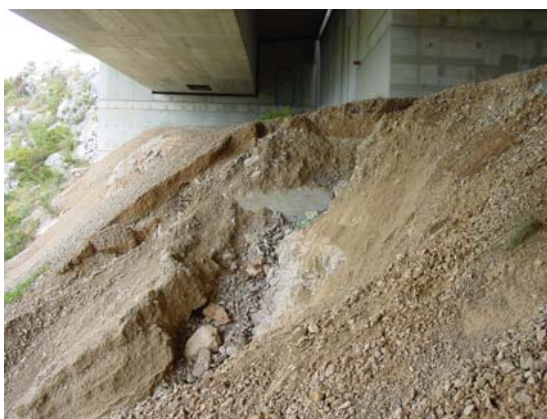
Slika 9: Tik pod viaduktom se lepo vidi, da voda odteka zunaj urejenega korita proti cevnem prepustu (CP 3)
