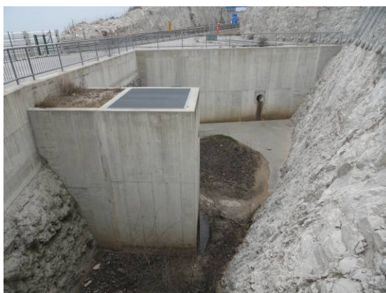
Slika 4: Gravitacijski lovilec olj in trdih delcev nad viaduktom Črni Kal
