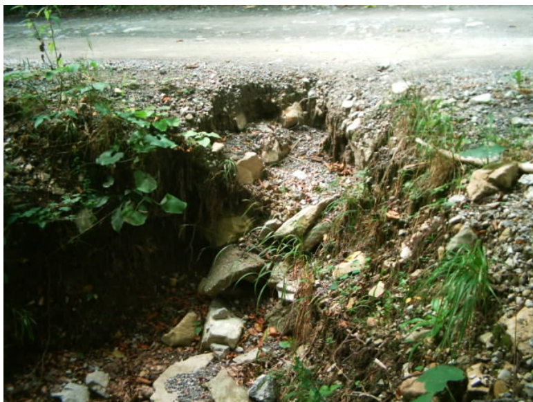
Slika 15: Poškodba ceste na mestu neurejenega iztoka cevnega propusta
