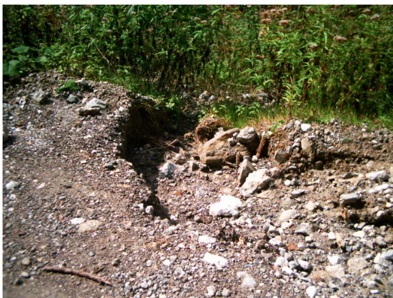
Slika 17: Poškodba ceste zaradi manjkajočega cevne propusta
