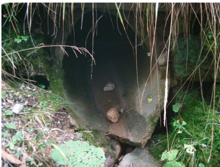
Slika 9: Poškodovana cev cevne propusta
