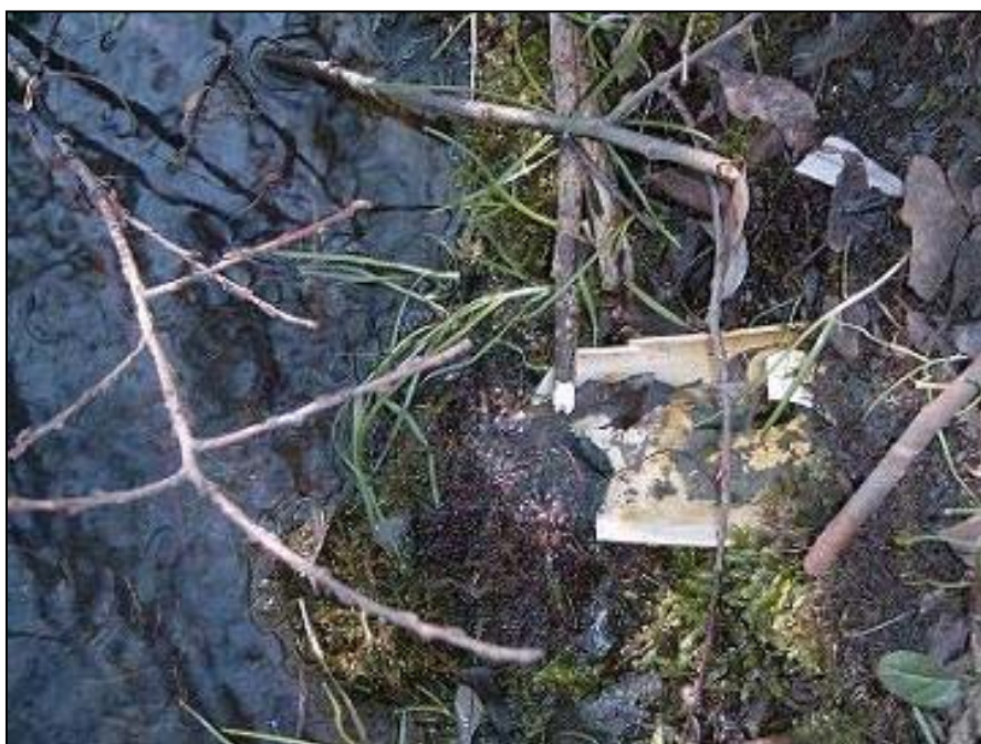
Priloga E7: Poškodba izlivke zaradi neustreznega vzdrževanja.
