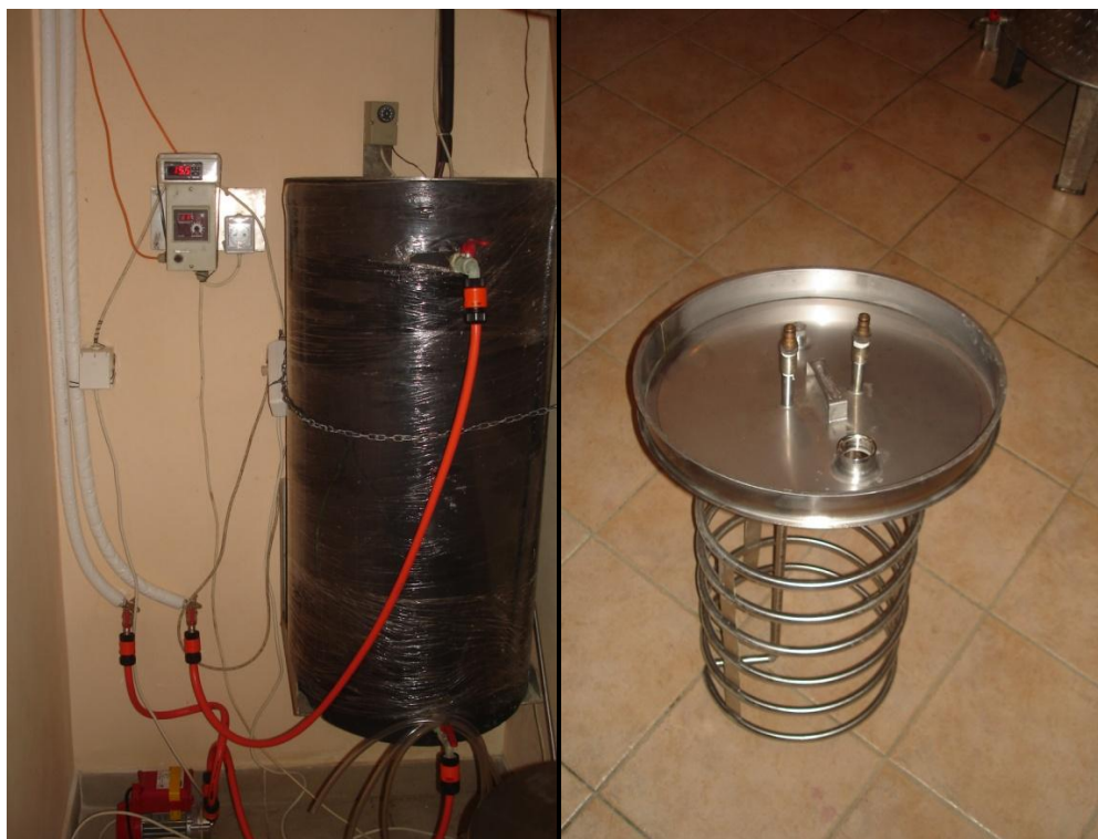
Slika 4: Hladilni sistem za hlajenje mošta in kontroliranje temperature med fermentacijo s pomočjo spiral iz nerjavečega jekla
