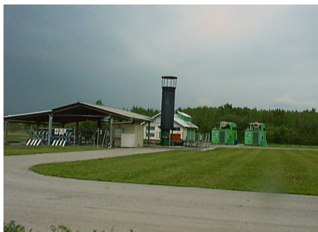
Slika 3: Črpališče plina z baklo in motorjema na odlagališču Ljubljansko barje (Črpališče..., 2006)
