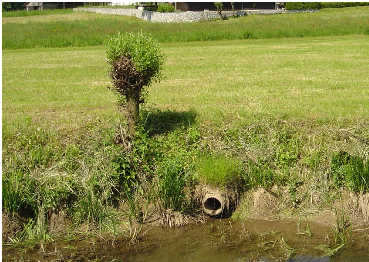
Slika 6: Nelegalni kanalizacijski izpust iz zasebnega objekta v reko Temenico.
