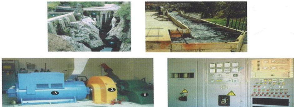
Slika 10: Zgoraj levo – betonski jez, groba rešetka in peskolov; zgoraj desno – leseni dovodni kanal; spodaj levo – (1) turbina, (2) vztrajnik, (3) generator v strojnici; spodaj desno – energetska upravljalna omara v strojnici (Novak in Medved, 2000: 184)
