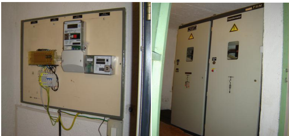
Slika 23: Števec za registracijo oddane električne energije ter visokonapetostna celica
