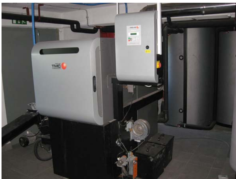
Slika 2: Kotlovnica na biomaso (foto: Jemec U., 1. 8. 2010)
