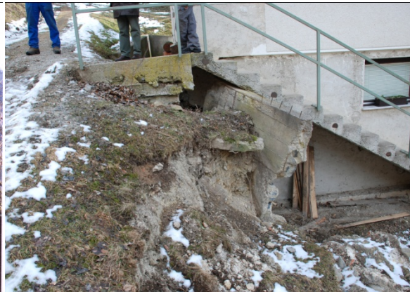
Poškodbe na stopnišču pred hišo v Smolevi (foto: Jerman Jasna, 2009)
