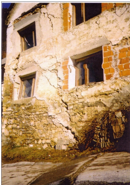
Poškodbe na stari hiši v Smolevi zaradi plazenja, hiša je bila porušena (Lazar, 2002)
