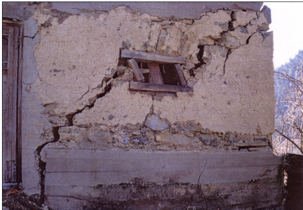
Poškodbe na hlevu v Smolevi, ki je bil porušen (Lazar, 2002)
