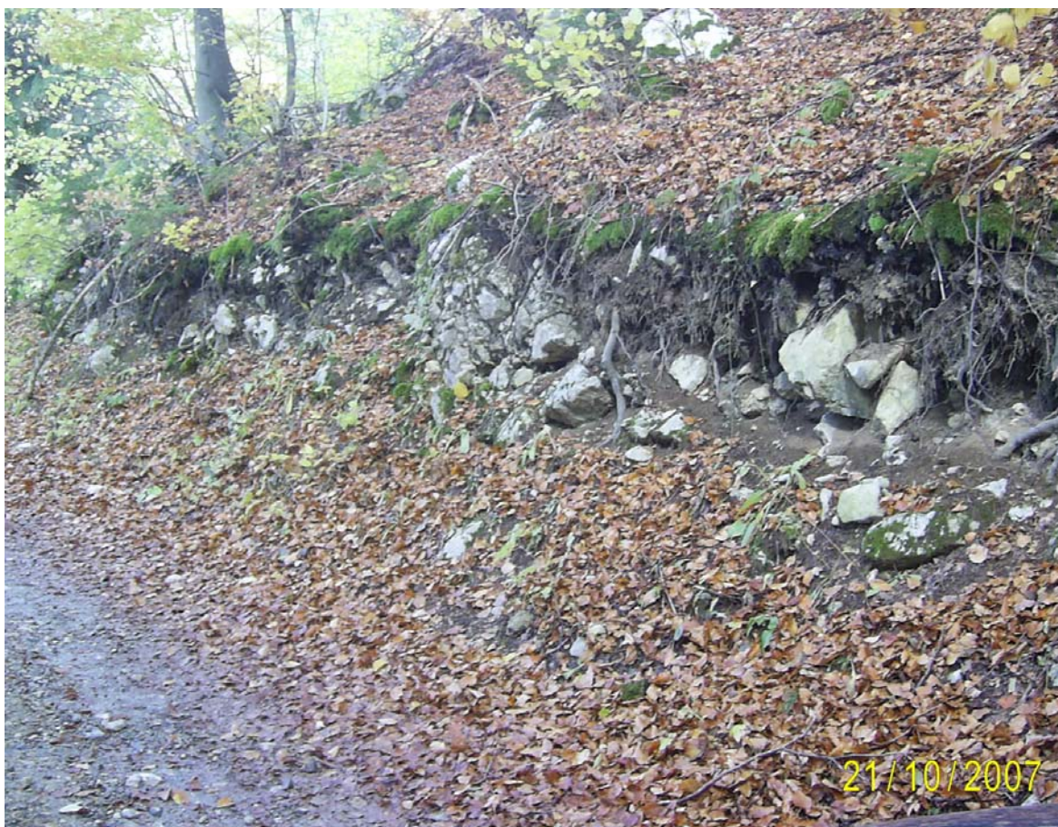
Slika 21: Nepravilno oblikovana odkopna brežina
