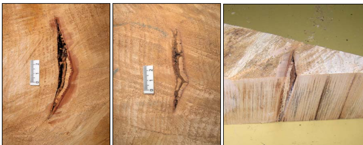
Slika 78: Razpoka s spodnje (a) in zgornje (b) strani koluta ter vzdolžni prerez (c)
