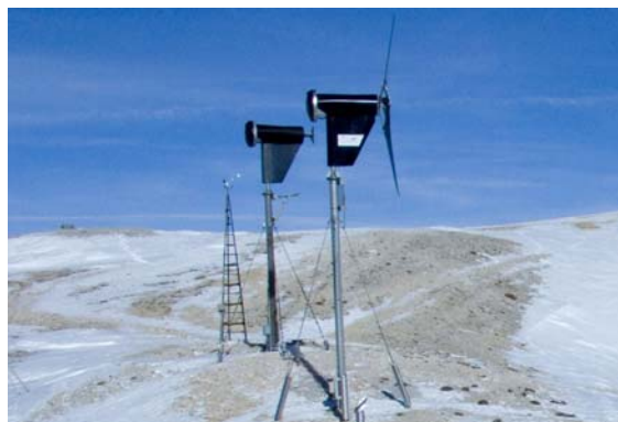
Slika 25: Vetrna generatorja pri Triglavskemu domu na Kredarici (foto: Franc Kaučič)
