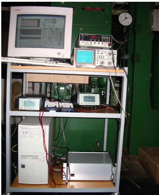
Slika 19: Frekvenčni generator, ojačevalci signala, ojačevalec in računalnik
