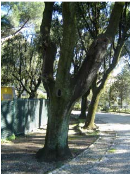
Slika 55: Park Pratogiardino, Viterbo, Italija: odmirajoča veja na A strani in poškodba na B strani drevesa št. 239
