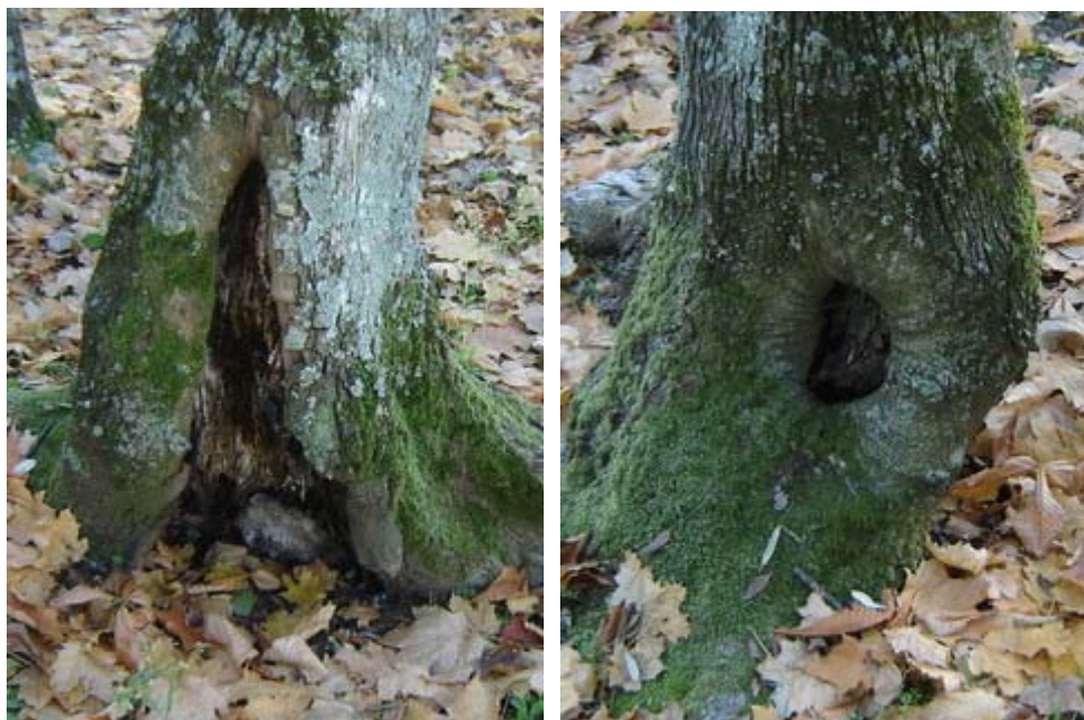
Slika 99 (levo): Park Pratogiardino, Viterbo, Italija: poškodovan koreničnik drevesa št. 105 Slika 100 (desno): Park Pratogiardino, Viterbo, Italija: poškodba na deblu drevesa št. 105
