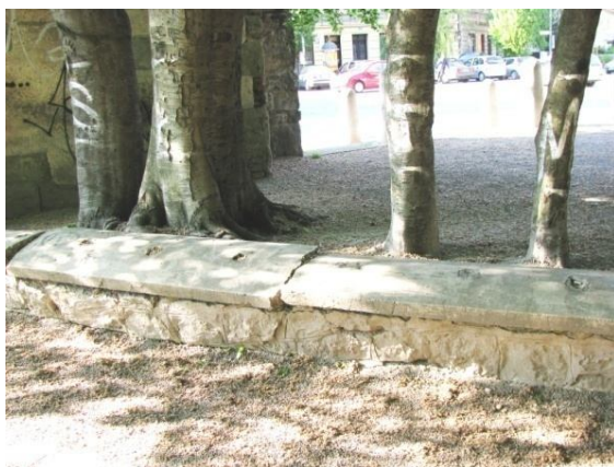
Slika 26 (levo): Poškodovan zid zaradi korenin
