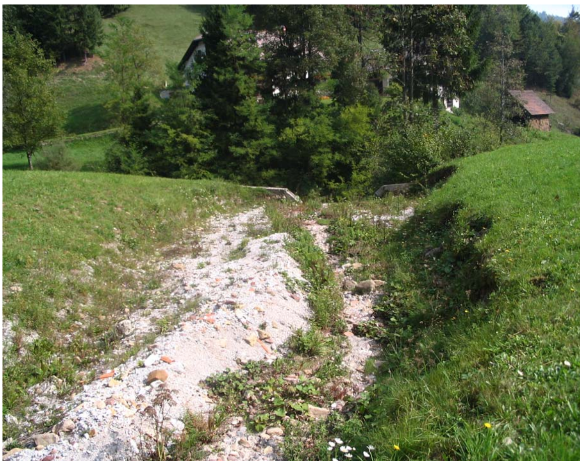
Slika 17 – Povsem poln zaplavek za pregrado v Šuštarjevem potoku je potreben čiščenja
