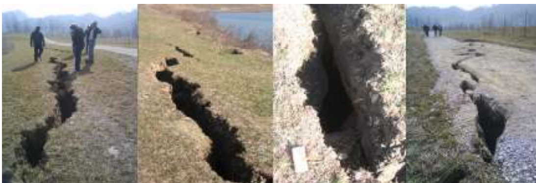
Slika 47: Razpoke kakršne se pojavljajo na poteh in brežinah pregrade zaradi ugrezanja površja
