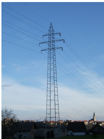
Slika 14: Daljnovod (fotografija: S. Zaletel)
