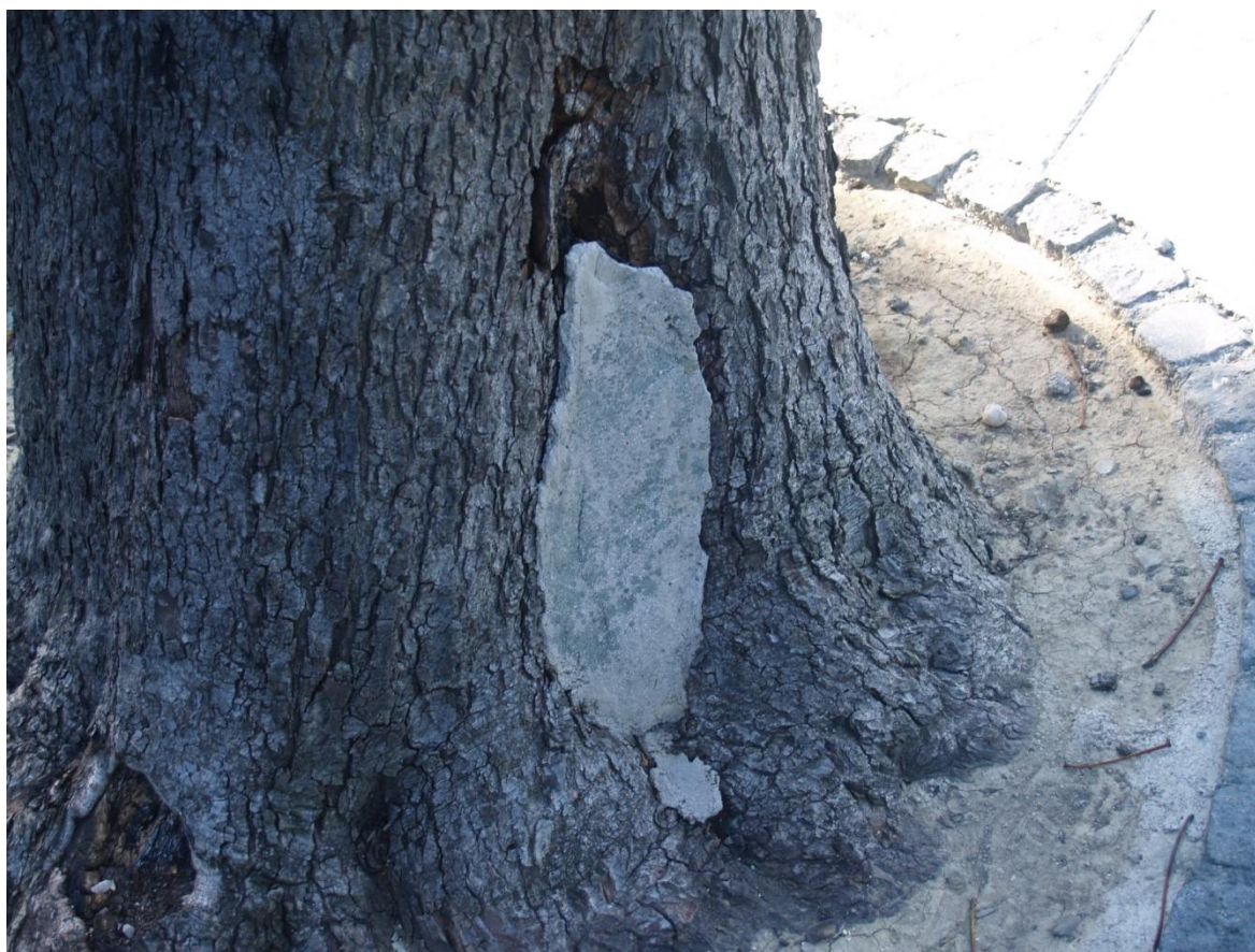
Slika 22: Napačno postopanje gradbenih delavcev (betonski zamašek)
