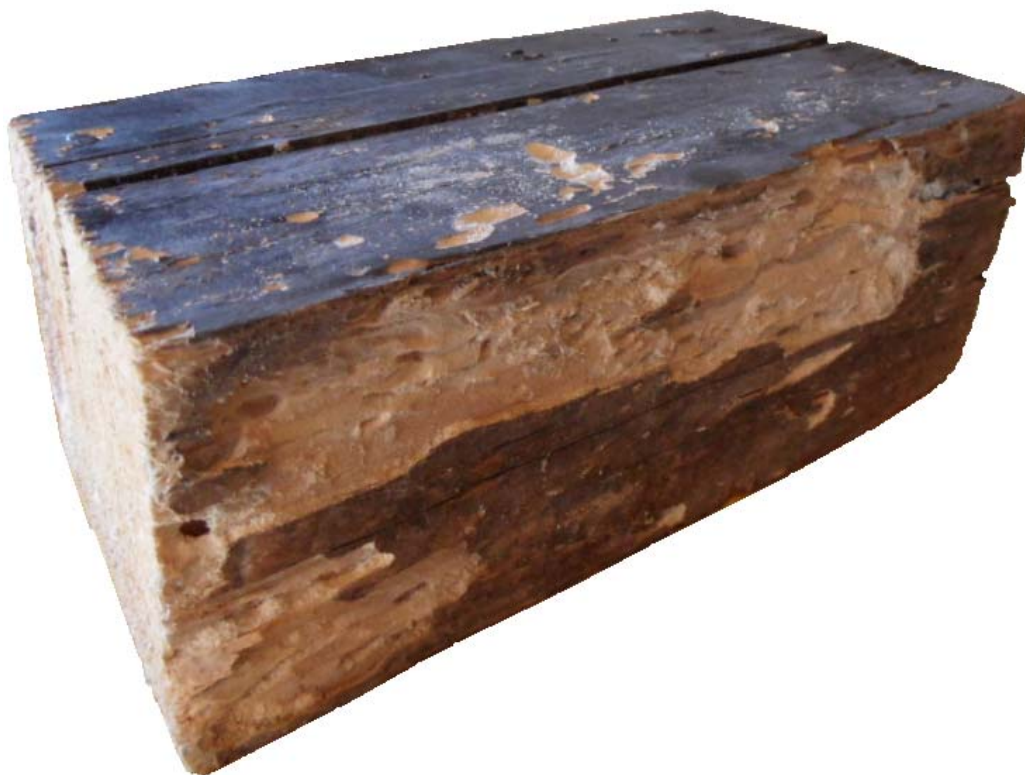
Slika 14: Tram s strani, zgornji sloj odkrušen stran, vidne velike poškodbe hišnega kozlička (foto: B. Mikuš)
