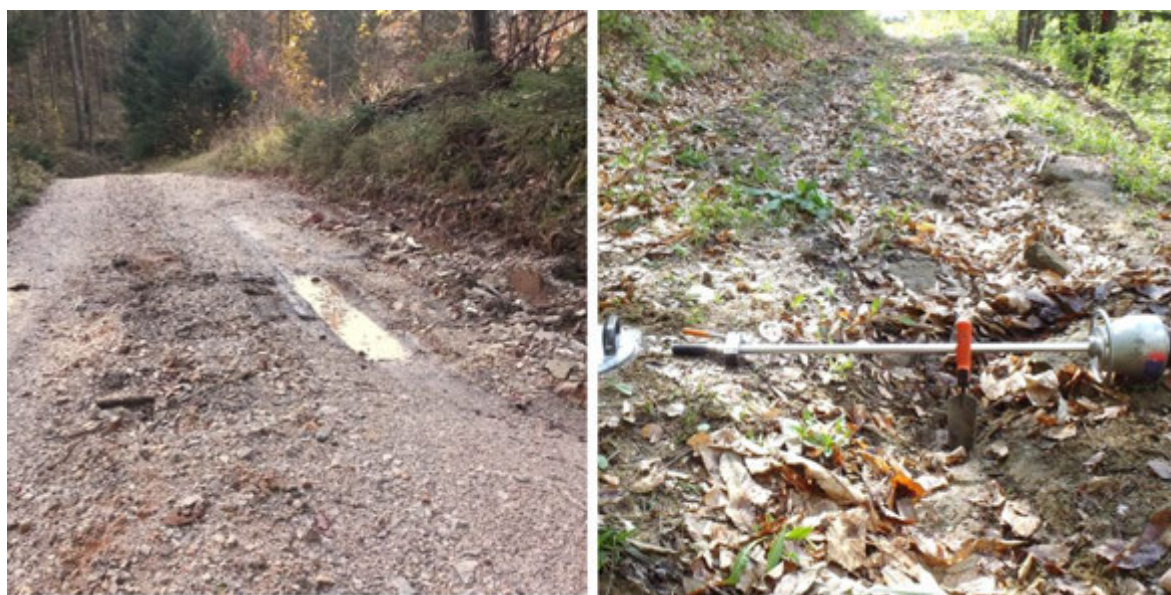
Slika 9: Tipične trajne poškodbe gramoznih vozišč na ravnih (levo) in strmih (desno) odsekih
