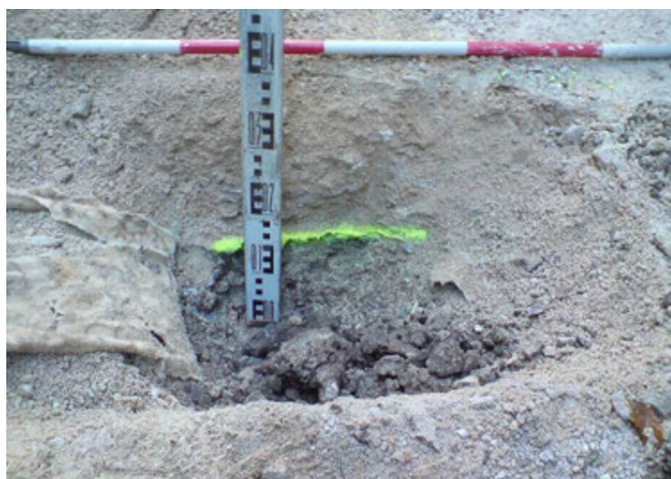
Slika 46: Neustrezna voziščna konstrukcija tretjega odseka na gozdni cesti »Knipajz« (cesta 4 v preglednici 9) Figure 46: Inappropriate pavement of the third section on the forest road »Knipajz« (road No. 4 in table 9)
