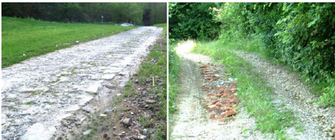
Slika 20: Ostanki telfordskega tlaka na gozdni cesti (levo) in neustrezna sanacija napačno izdelanega vozišča s prodnato obrabno plastjo (desno)
