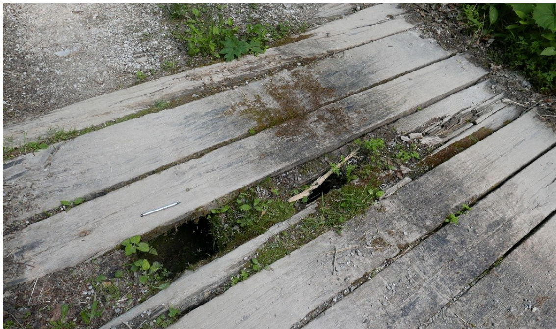
Slika 19: Poškodovan element vozne površine mostu (Foto: Miha Černe)
