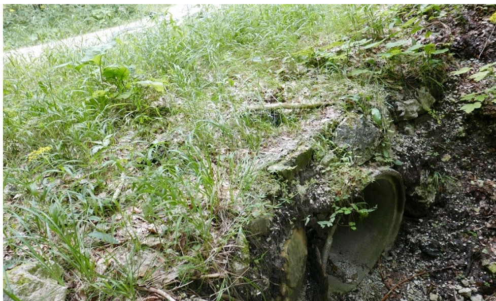
Slika 13: Premalo globoka vgradnja cevi (Foto: Miha Černe)
