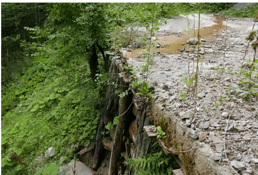
Slika 18: Pred vodo nezavarovan podporni zid (Foto: Miha Černe)
