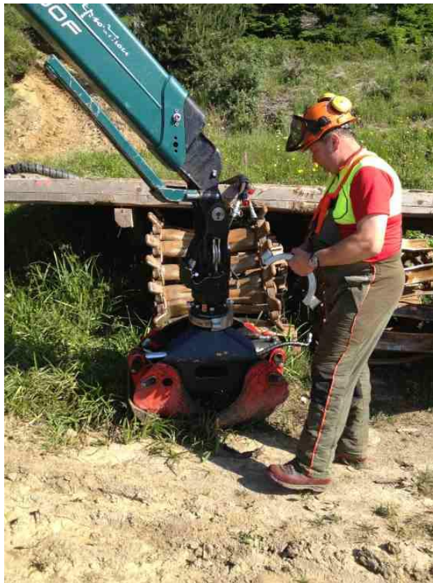
Slika 10: Montaža klešč za nalaganje hlodovine (foto: Saša Kencijan)
