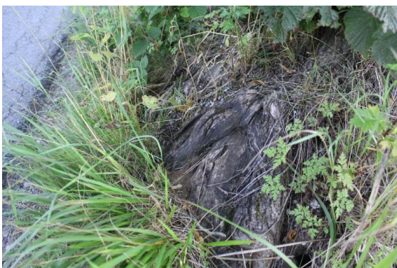
Slika 30: Nepreraščena poškodba trikotne oblike na koreničniku na A.
