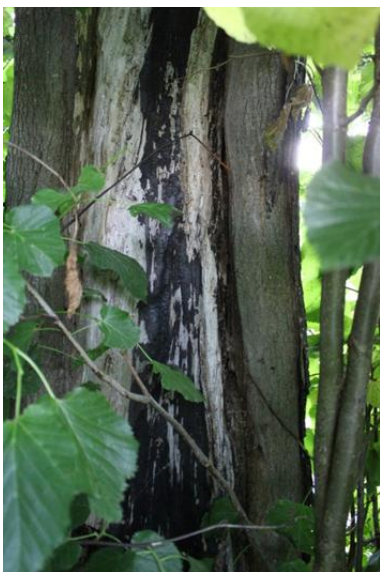
Slika 39: Nepreraščena poškodba čez celotno stran C od tal do višine 2,5 m z znaki trohnenja.
