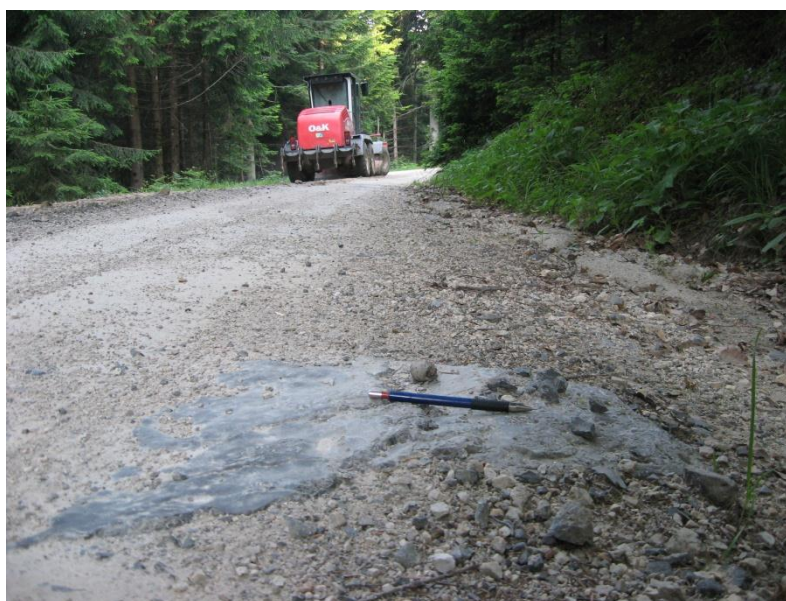
Slika 8: Vidni elementi nosilne plasti zaradi poškodb obrabne plasti (Mirtil, 2013)
