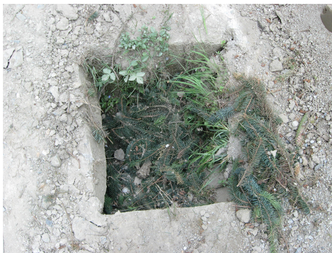
Slika 7: Poškodovan oziroma zasut vložni jašek cevne propusta (Mirtič, 2013)
