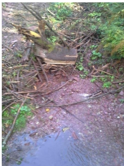
Slika 12: Posledice že opravljene sanacije (razred 7) (foto: M. Šink, oktober 2014)
