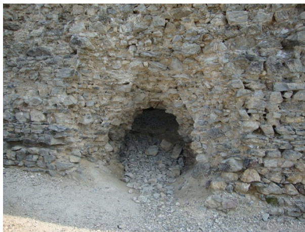
Slika 19: Luknja v južni steni stolpa. Tu je dobro viden drobir, ki pada iz vrha stolpa.
