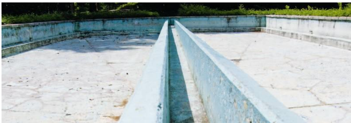
Slika 36: Nefunkcionalen bazen kazi izgled parka in je potreben sanacije (Portal, 2012)
