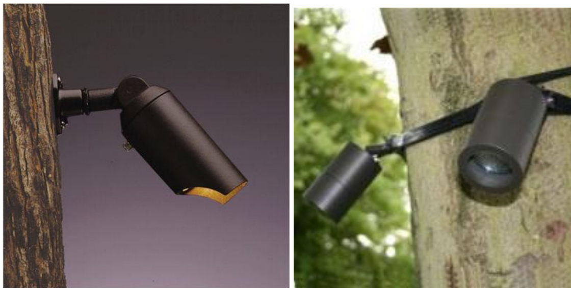
Slika 14: Primera pritrditve na drevo; slika levo prikazuje privijačeno svetilo na deblo (ki se pri nas odsvetuje), na sliki desno pa so svetila pritrjena s PVC objemko (Tree Light Spotlights, Outdoor Lighting Choices)
