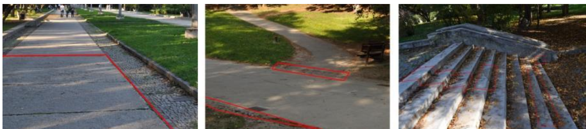
Slika 34: Slabo vzdrževane poti in stopnišča lahko, zaradi dotrajanosti materialov in posedanja betonskih plošč, predstavljajo tudi nevarnost za sprehajalce
