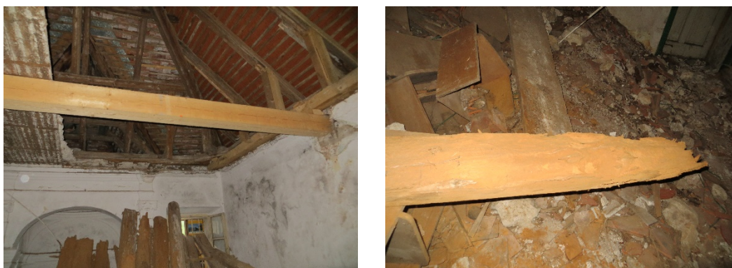
Slika 1: Delno porušena stropna konstrukcija v graščini Preddvor (levo). Močno degradiran stropnik (desno).
