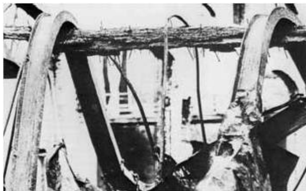
Slika 22: Primerjava lesene in jeklene konstrukcije po požaru. Lesena je ohranila svojo nosilnost, medtem ko je pri jekleni konstrukciji zaradi vročine prišlo do porušitve (J Rose Carpentry, 2015)
