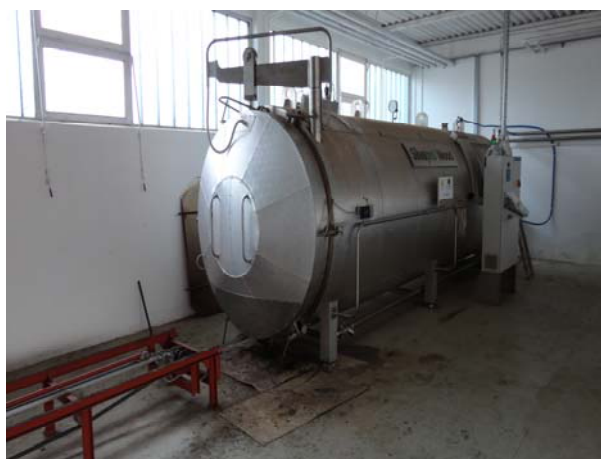
Slika 3: Komora za vakuumsko modifikacijo lesa v podjetju Silvaproduct d.o.o.
