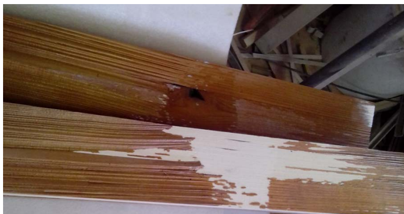
Slika 42: Delna delaminacija in prelom po lesu.
