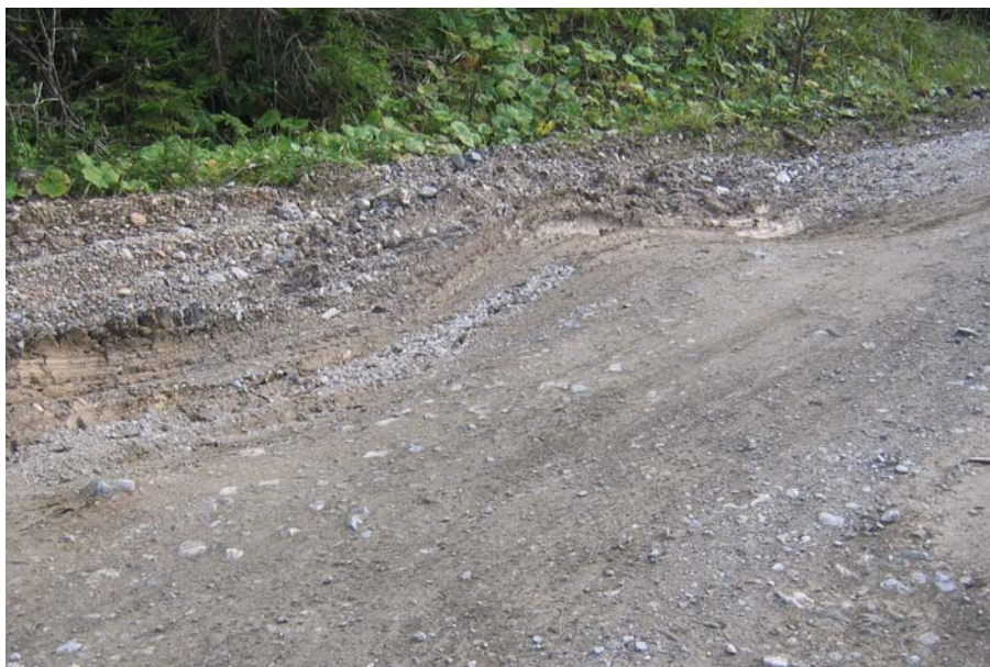
Slika 7: Deformacije vozišča zaradi velikih osnih obremenitev v Fevči (Foto: Ahačič, 2006)
