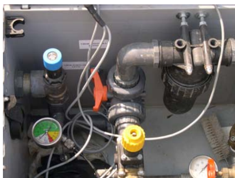
Slika 23: Naprava za merjenje pretoka črpalke (foto: D. Danijel)
