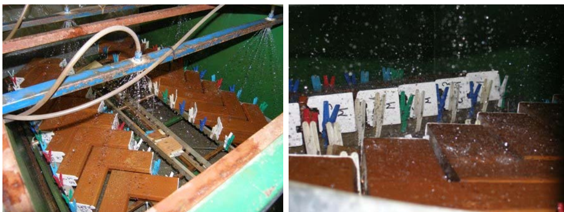
Slika 36: Delovanje komore (šobe za razprševanje vode)
