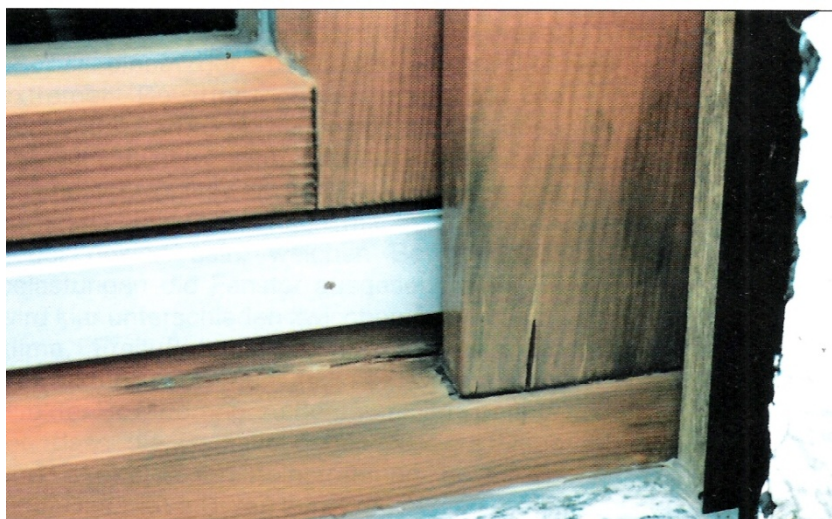
Slika 4: Poškodbe na oknu zaradi slabe zaščite spojev
