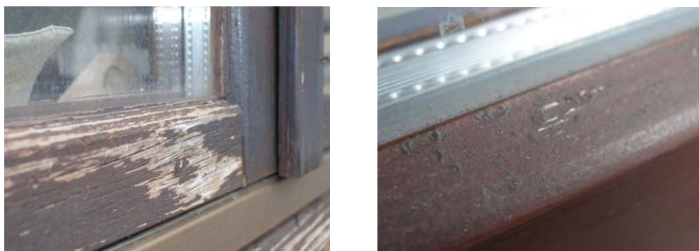
Slika 10: Poškodbe zaradi pomanjkanja odkapne letve
