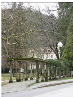
Slika 14: Obnove potrebna pergola v zgornjem delu parka.
