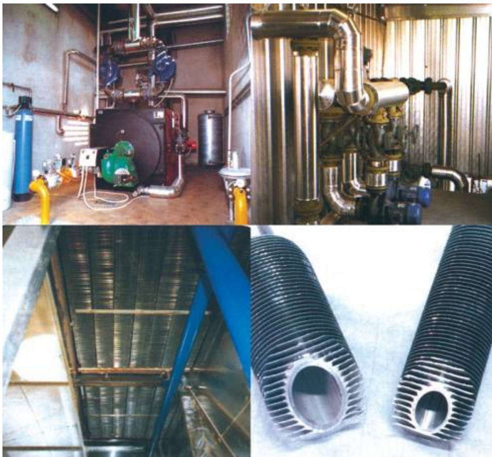
Slika 3 Sistem ogrevanja: zgoraj levo – kotlovnica; zgoraj desno – razdelilnik toplotnega medija; spodaj levo – grelni register cevi z navitjem in spodaj desno – cev z navojem pločevine (Gorišek, 2004).
