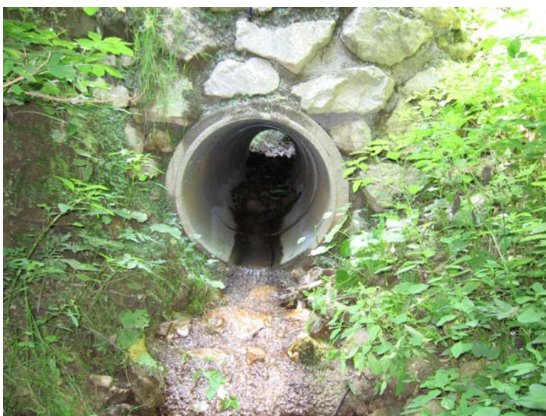
Slika 19: Pravilno urejen iztok cevnega propusta
