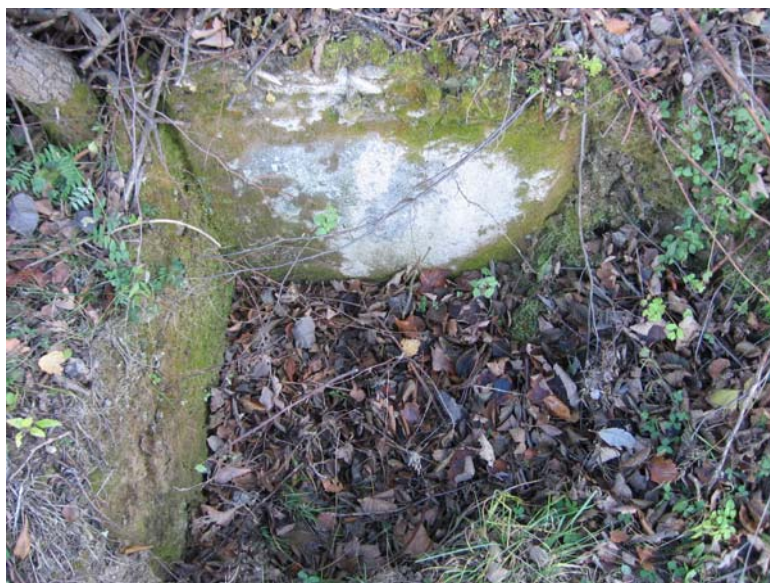
Slika 6: Dotrajan in zamašen betonski vtočni jašek
