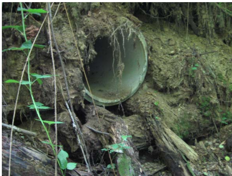
Slika 21: Neprimerna vgradnja cevi
