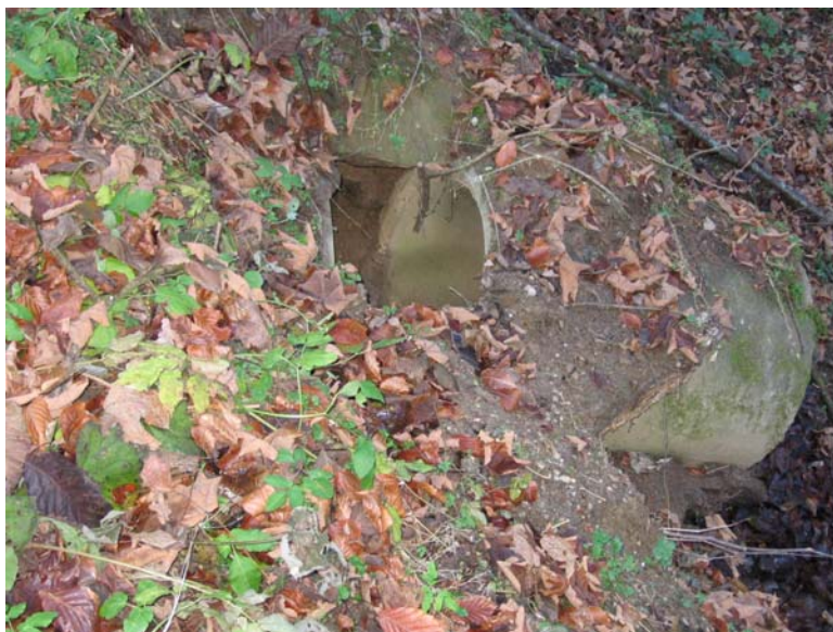
Slika 18: Poškodba zaradi neurejenega iztoka cevnega propusta
