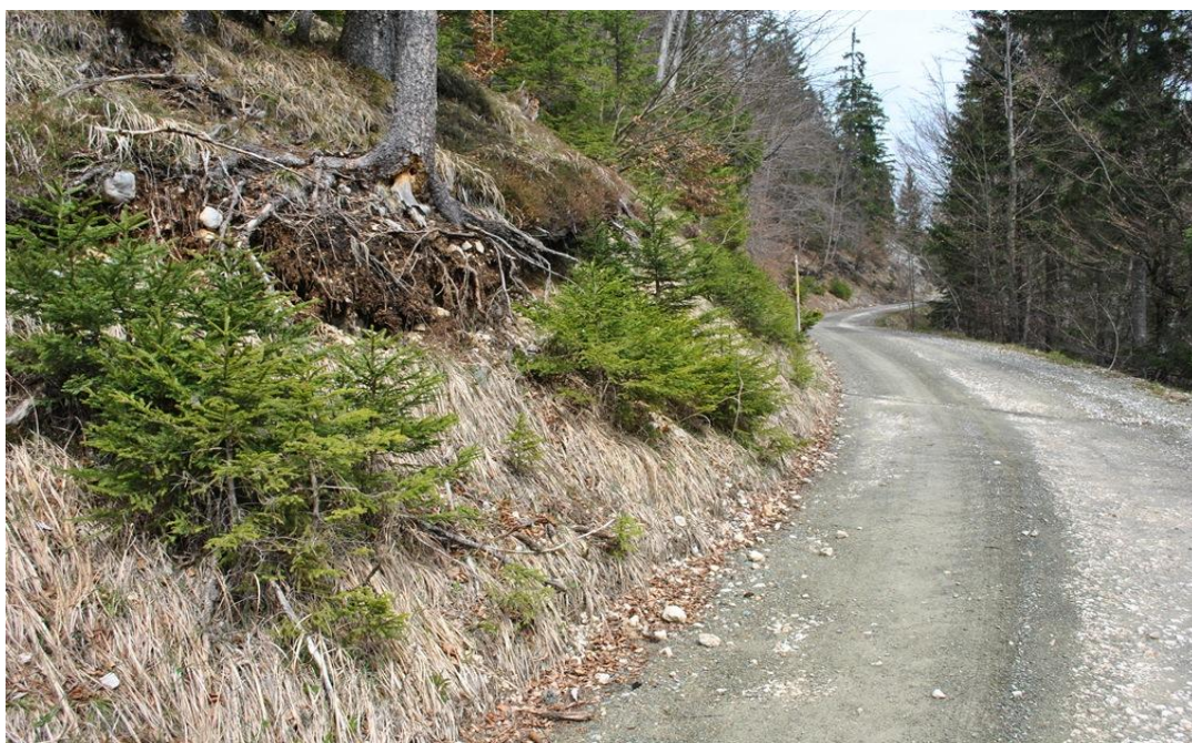
Slika 29: Mlade smreke, ki počasi zaraščajo odkopno brežino na gozdni cesti zgrajeni leta 1986 (foto: Potočnik M.,2012)
