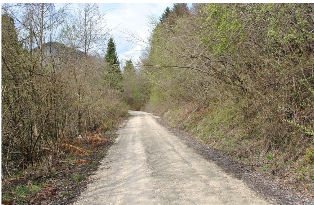
Slika 32: Dobro zaraščeni brežini na cesti zgrajeni leta 1937 (foto: Potočnik M.,2012)
