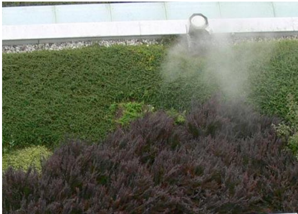
Slika 36: Izpust prezračevalne naprave
