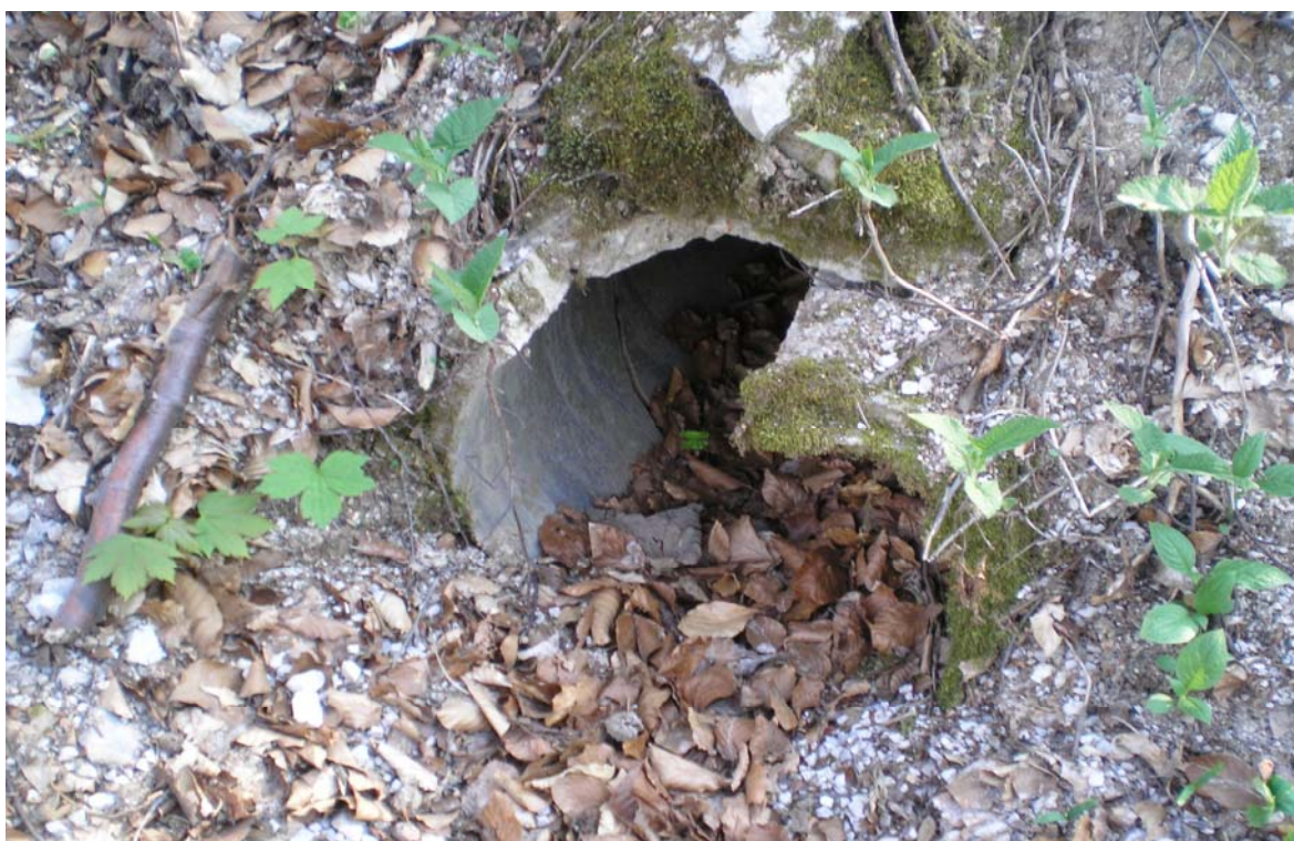
Slika 8: Poškodovana cev cevne propusta (Foto: Šega, 2008)
