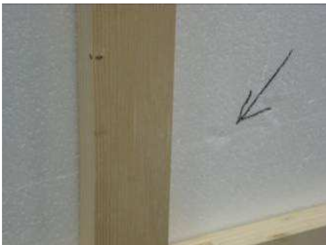
Slika 49: Porušitev ekspandiranega polistirena na delu med naslonskim in sedalnim delom
