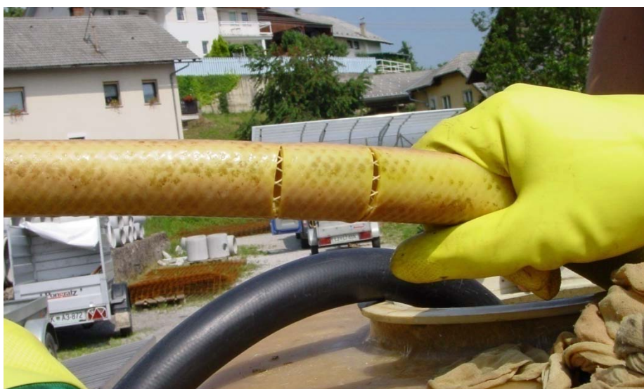
Slika 16: Poškodovani cevovodi, ki jih je potrebno zamenjati ( foto: V. Škedelj)
