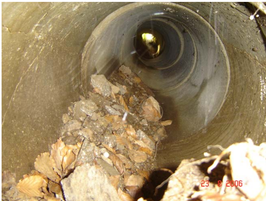
Slika 9: Razpoke na cevi in razmaknjenost na predelih spojev cevi (Foto: Šturm, 2006)
