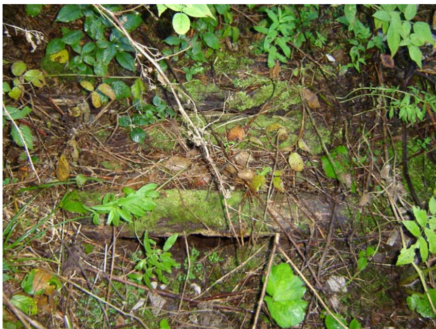
Slika 15: Lesen pokrov vtočnega jaška v zelo slabem stanju in močno zaraščena okolica (Foto: Šturm, 2006)
