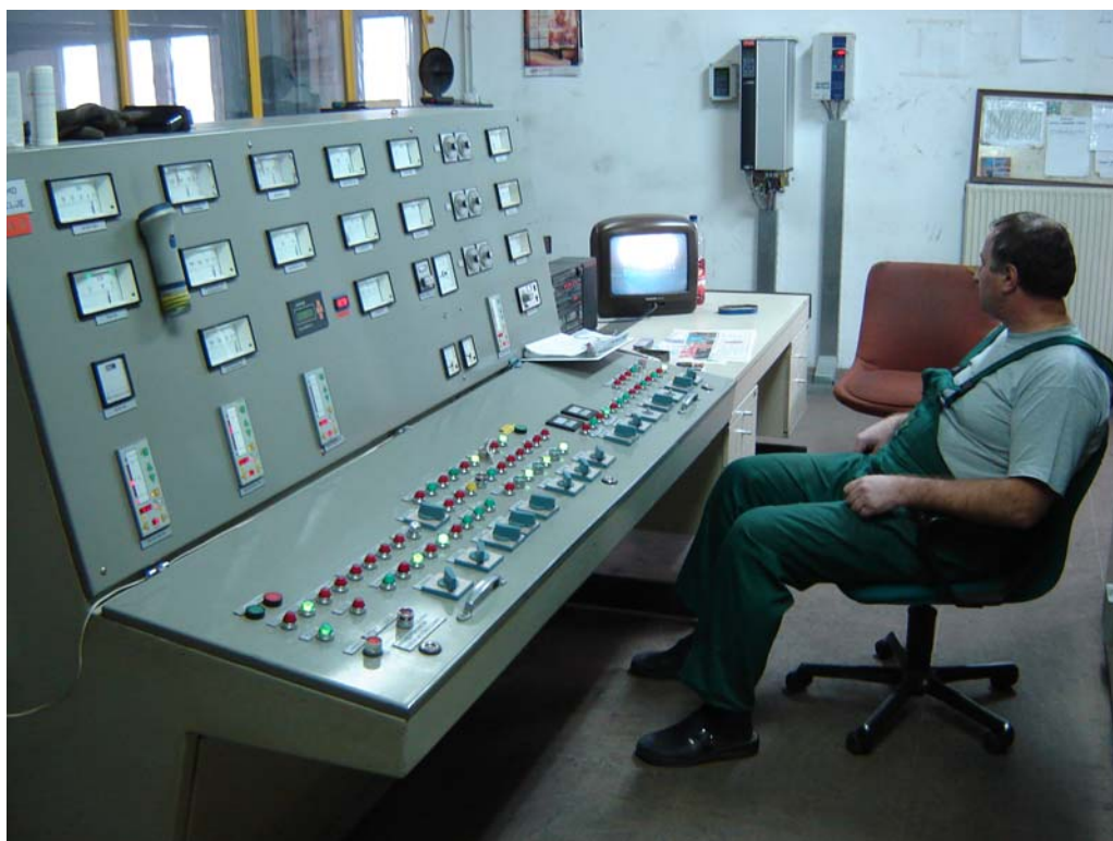
Slika 18: Kontrolna soba kogeneracije.
