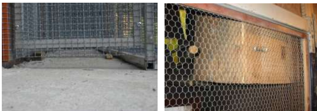
Sliki 57 in 58: Primer neprimerno grajene preletalnice. Omogočen je pobeg ali vstop zunanjih živali (levo) in premalo čvrste mreže (desno) (Foto: Pšeničnik, 2012).
